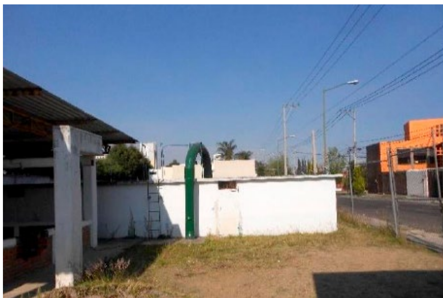
Tanque de almacenamiento
