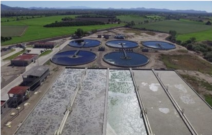
Vista aérea del sistema de lodos activados
