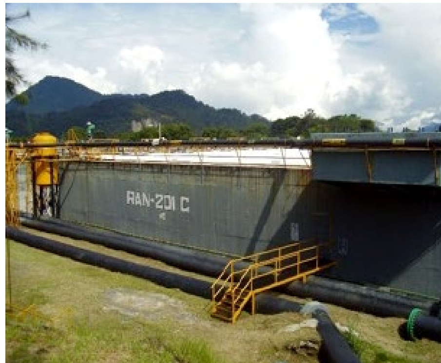
Reactor Anaerobio de Flujo Ascendente
