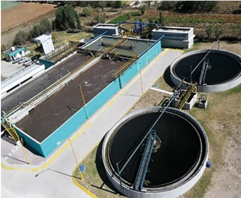
Reactores aerobios y sedimentadores secundarios
