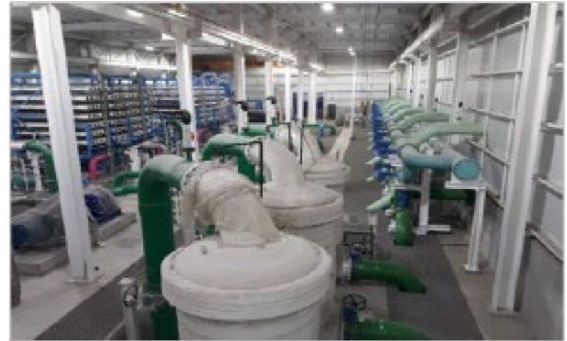
Filtros de cartucho y el múltiple de alimentación
