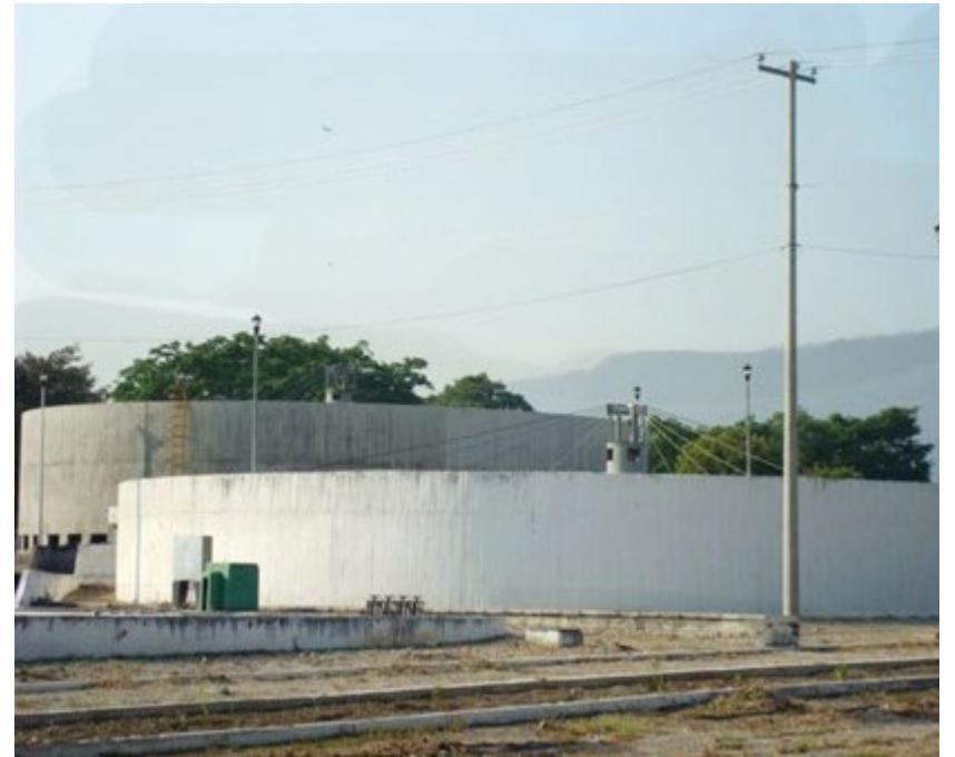
Filtros biológicos (percoladores)
