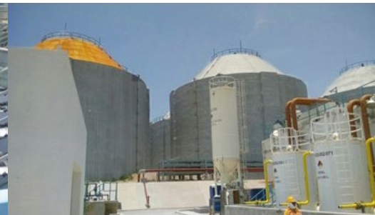
Digestor anaerobio de lodos
