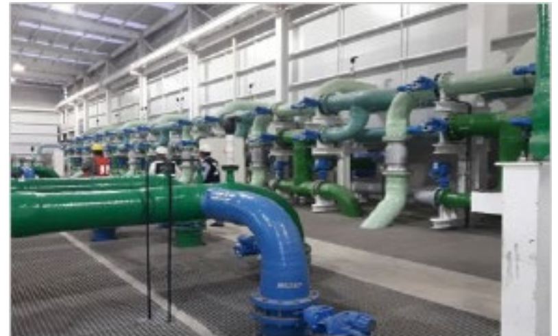
Tuberías del múltiple para el manejo del agua de mar
