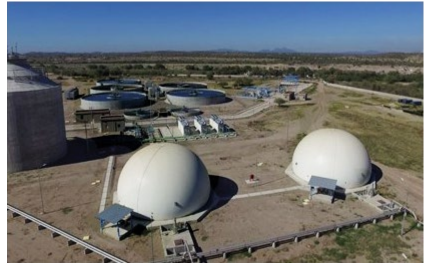
Almacenamiento de biogás y equipos de cogeneración
