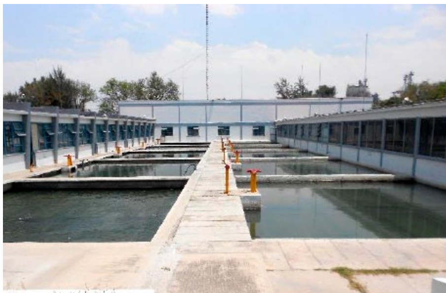
Filtros modulo 1 y 2
