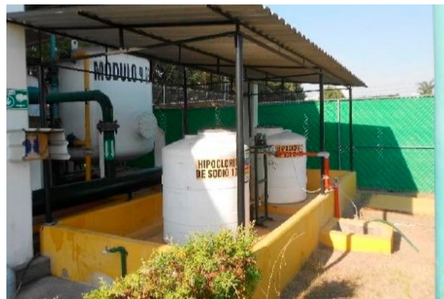
Dosificación de Hipoclorito de Sodio
