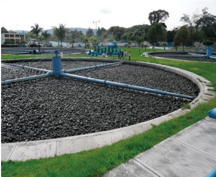
Filtro Biológico (percolador)
