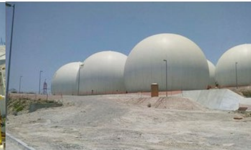
Almacenamiento de biogás
