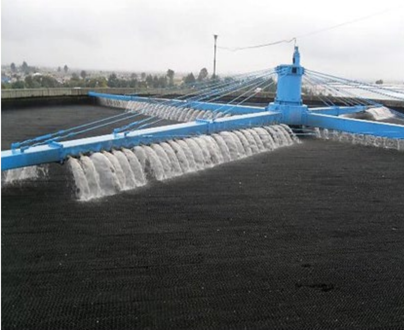
Filtro Biológico (percolador)
