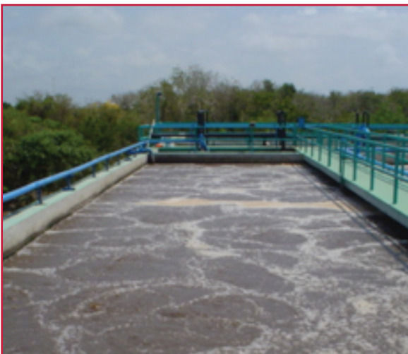
Ilustración 5.6 Vista superficial de un tanque de aireación con difusores de burbuja fina
