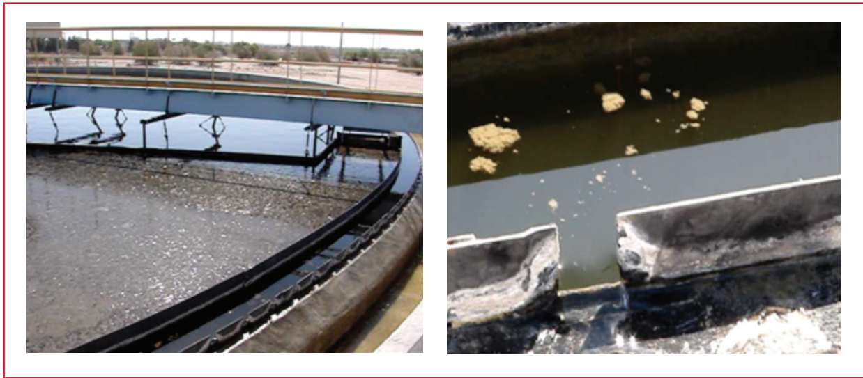
Ilustración 3.14 Grumos grandes presentes en la superficie del sedimentador secundario
