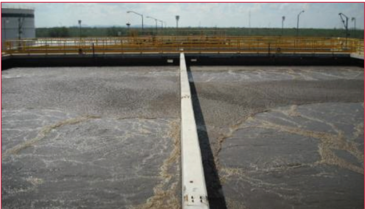
Ilustración 3.21 Tanque de aireación después del tratamiento
