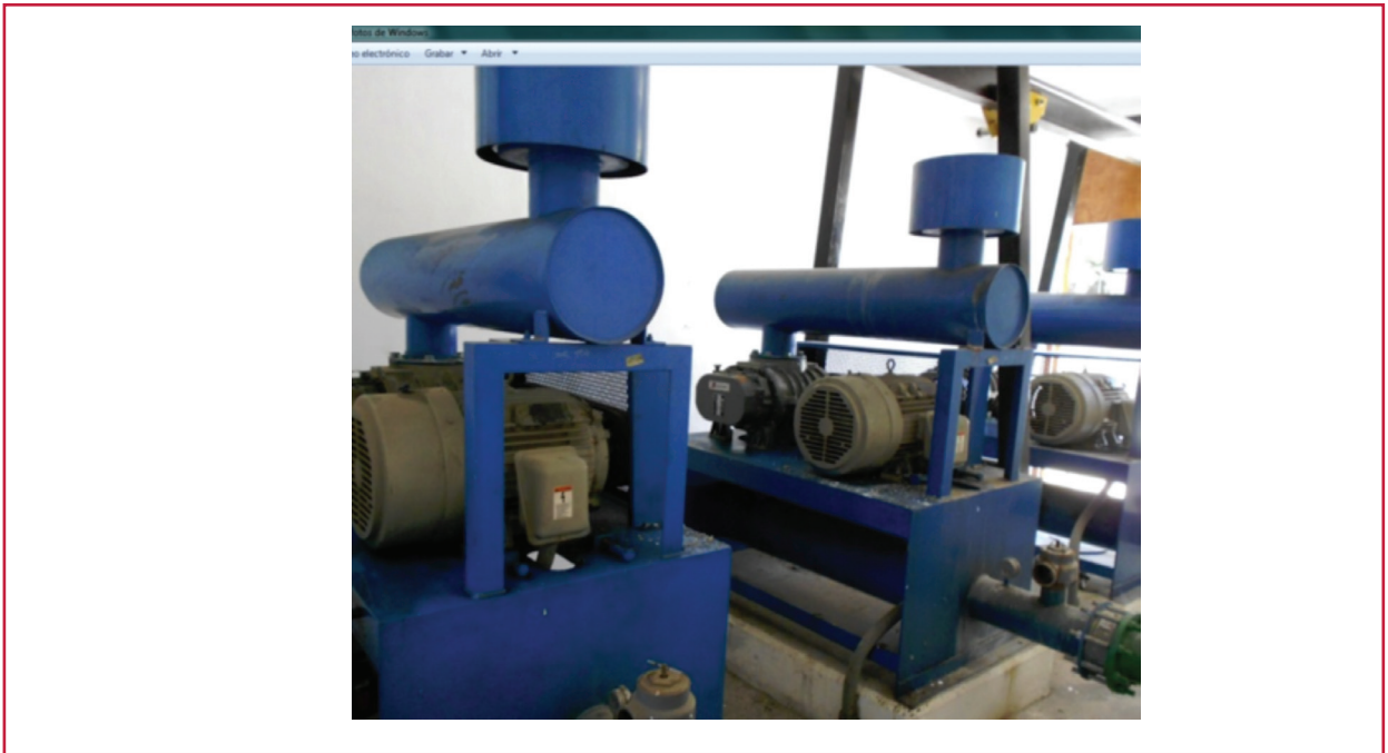
Ilustración C.32 Sopladores de lóbulos en operación
