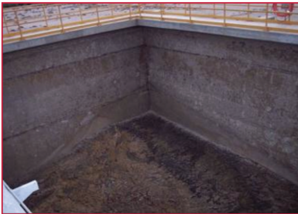
Ilustración 1.18 Tanque de regulación
