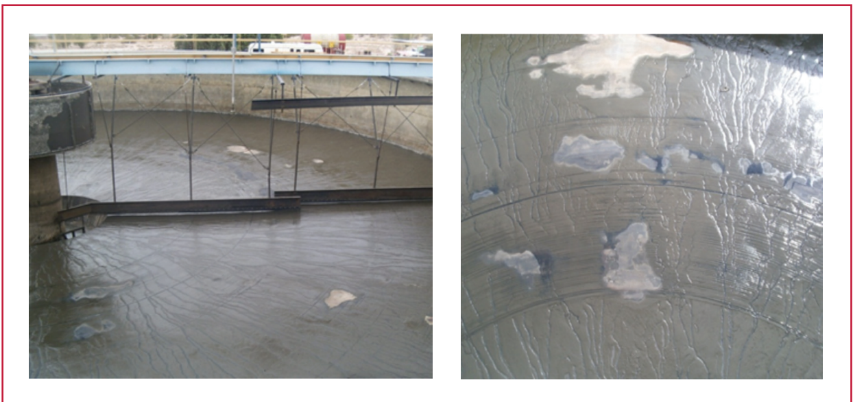
Ilustración 3.13 Superficie del sedimentador secundario mal nivelado
