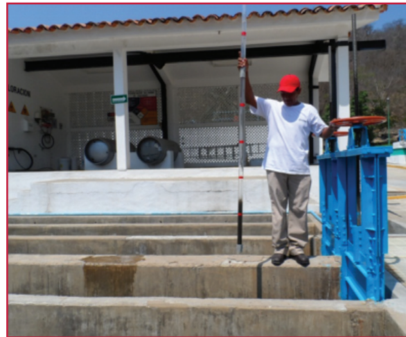
Ilustración 2.11 Verificación de acumulación de lodos
