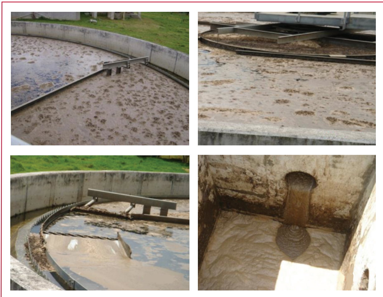
Ilustración 3.11 Presencia de natas en sedimentador secundario
