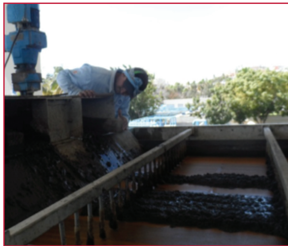
Ilustración 2.15 Verificación de la buena operación
