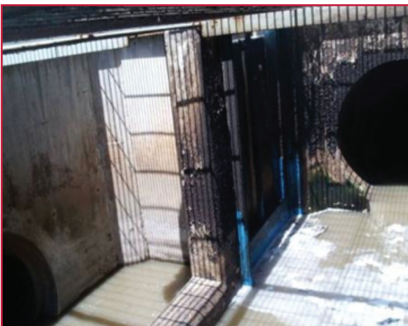
Ilustración 1.40 Bypass a la izquierda
