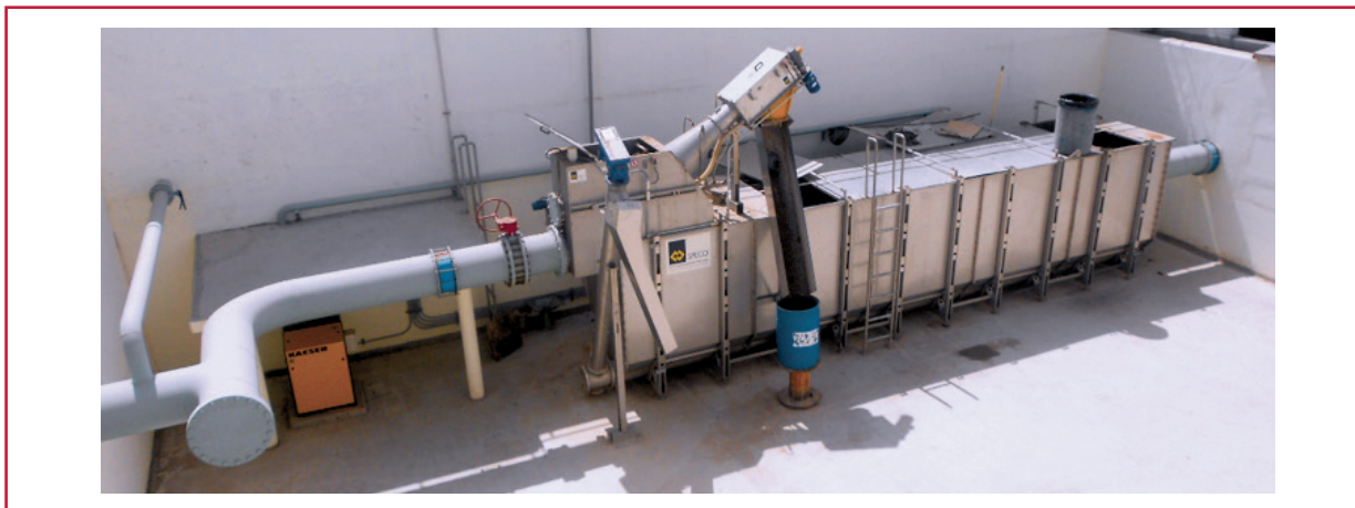
Ilustración 1.2 Rejillas automáticas de limpieza mecánica
