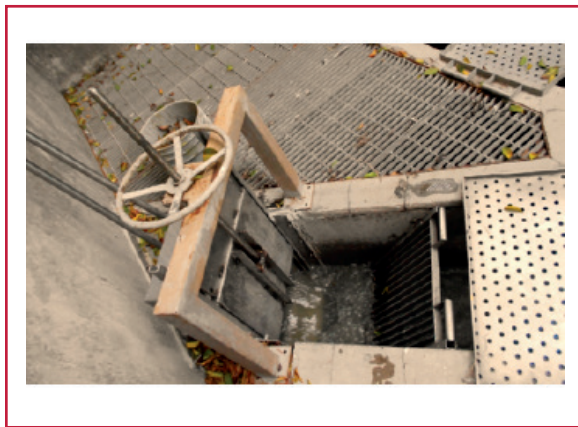
Ilustración 1.1 Rejilla de limpieza manual
